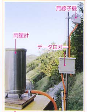
計測器設置状況
